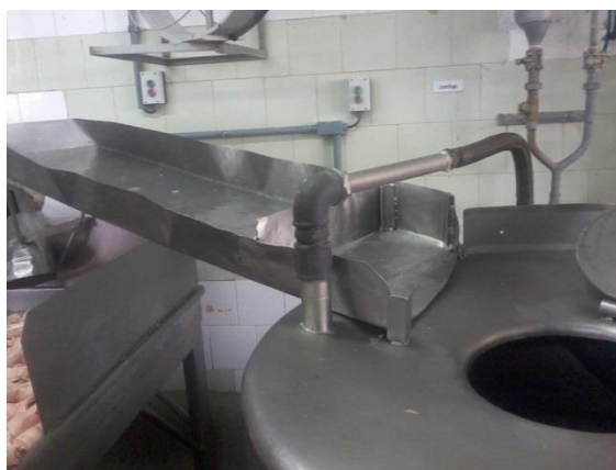
Imagem da calha de despejo e centrífuga de lavagem.
