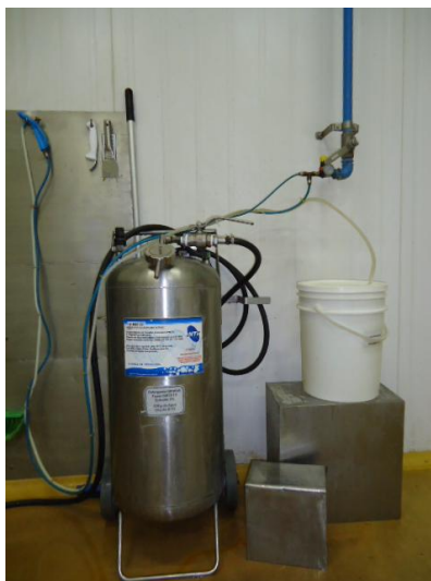
Figura 2: Gerador de espumas móvel da seção ESS
