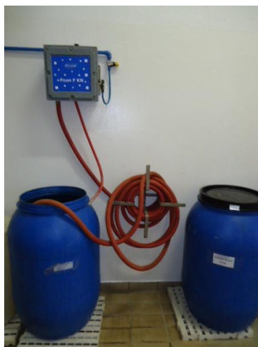
Figura 1: Gerador de espumas fixo da seção DET
