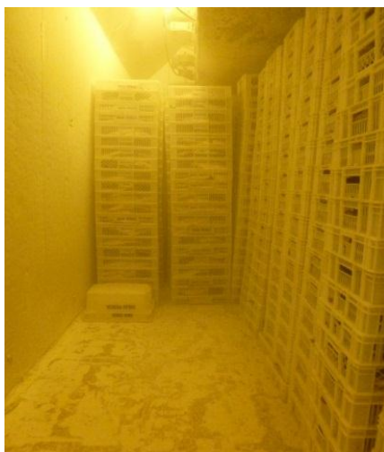
Figura 9 - Interior do túnel de congelamento.
